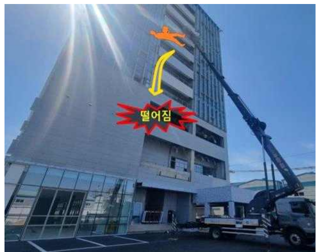
< 재해발생 현장 전경(예상) >
