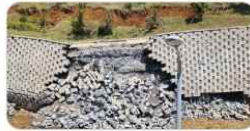
붕괴 위험(옹벽, 축대 등)
