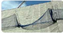
낙하물 방지망 파손
