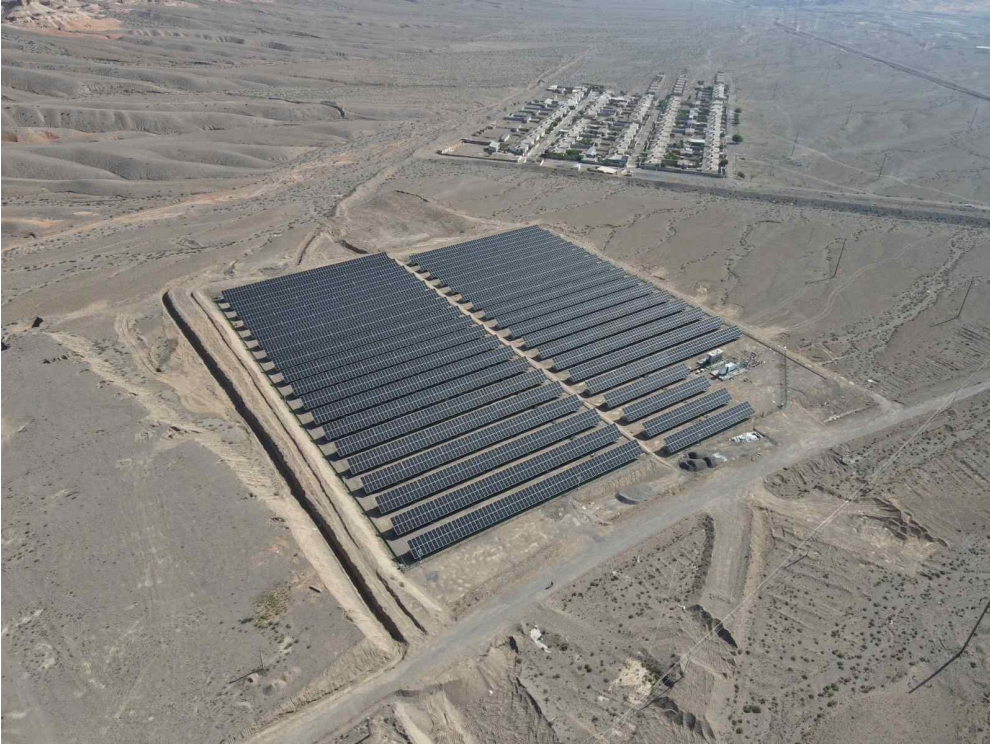
* 수그드 태양광 및 에너지저장장치 설비 현장
