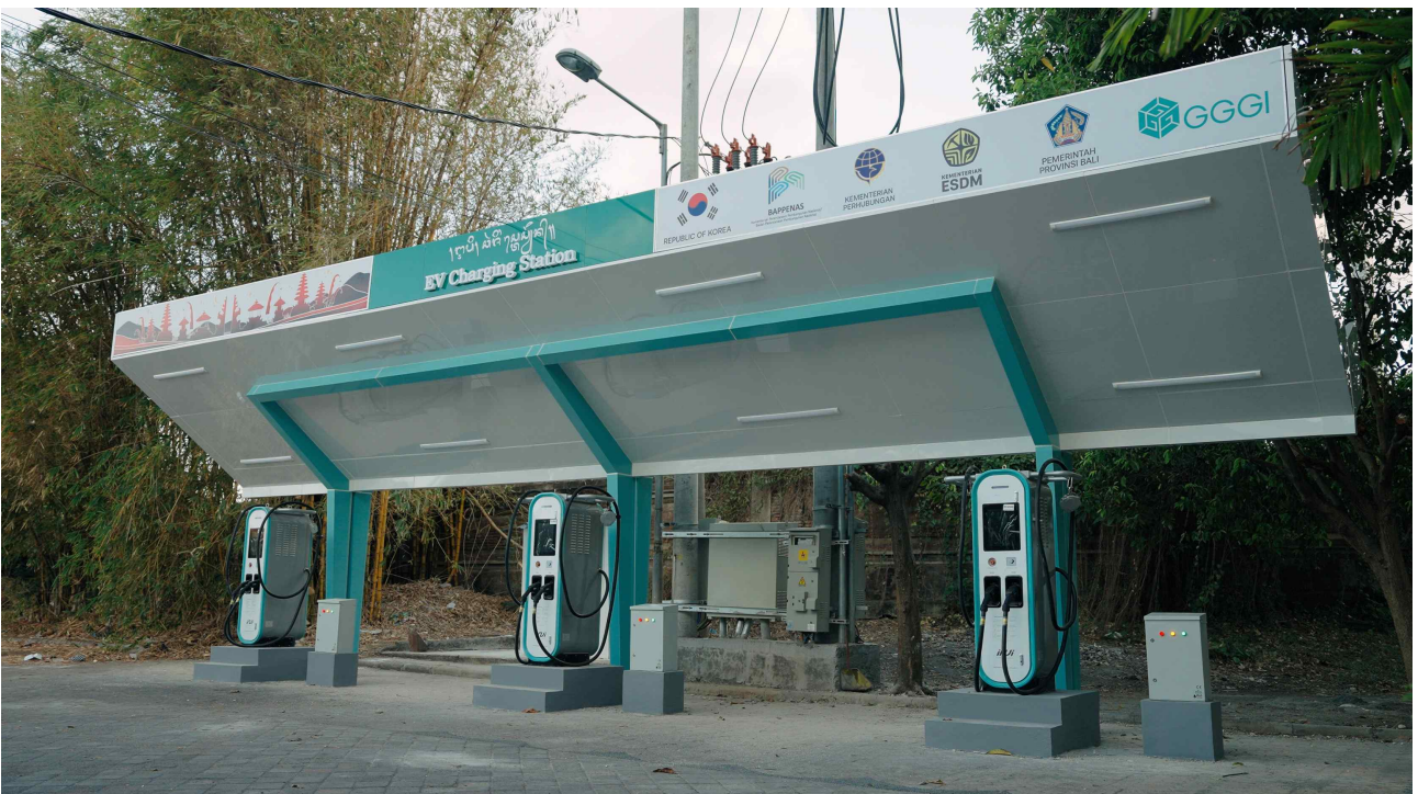
* 인도네시아 발리에 설치된 전기버스 충전소
