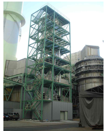
건식포집 플랜트 전경 (0.5MW, 10톤CO 2 /일)
