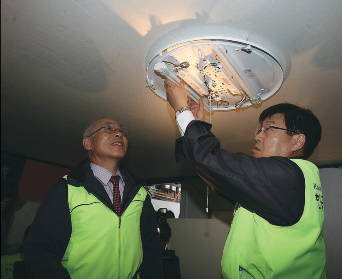
김영주 산업자원부장관(오른쪽)과 이세중 에너지재단이사장이 기초생활수급 저소득 가구의 집을 방문해 조명기기 교체 봉사활동을 하고 있다.
