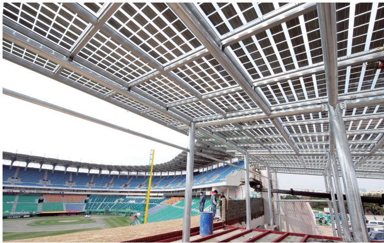
환경올림픽이 되려면 기반시설을 친환경적으로 건설하고, 탄소제로형 녹색경기장을 만들어야 한다. 사진은 태양광 발전시설이 설치된 인천문학구장 모습. 인천문학구장은 태양광 발전설비, 태양광 바비큐 존, 자전거 거처대 등이 새로 설치돼 '그린 문학구장'으로 탈바꿈했다.
