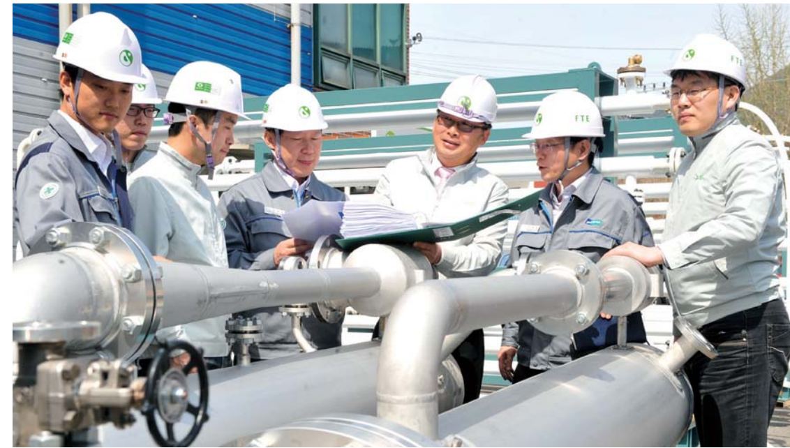
경남 김해시 주촌면 선지리 ㈜에프티이(FTE) 공장에서 임직원들과 두산중공업 관계자들이 담수화 설비 진공 장치의 품질 상태 등을 점검하고 있다.
